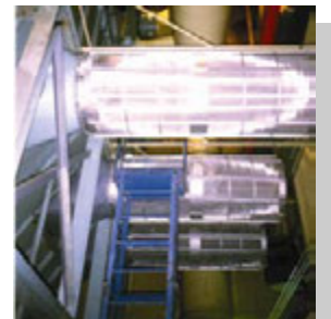
鋳物工場の集塵機への設置例
